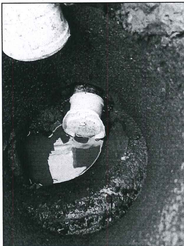
Figura 5-Válvula de retenção instalada no CDC nº 1717762-6.
