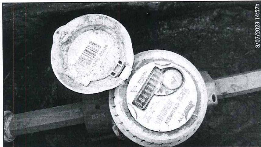
Figura 1- Constatação de violação no hidrômetro.
