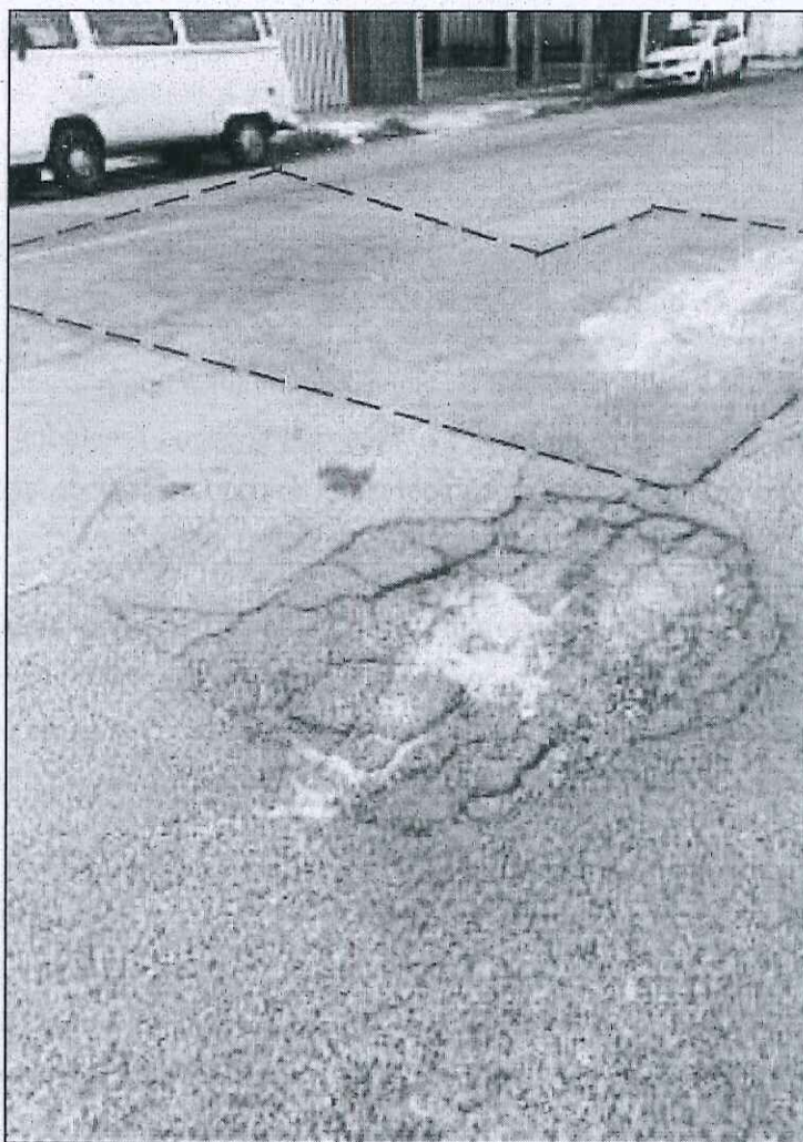
Figura 4- Rua dos Andradas, n° 1127- o trecho destacado em vermelho evidencia onde a Concessionária realizou intervenção e realizou a recomposição asfáltica, sem recalques. O trecho que apresenta deformação não foi alvo de intervenção pela BRK.
