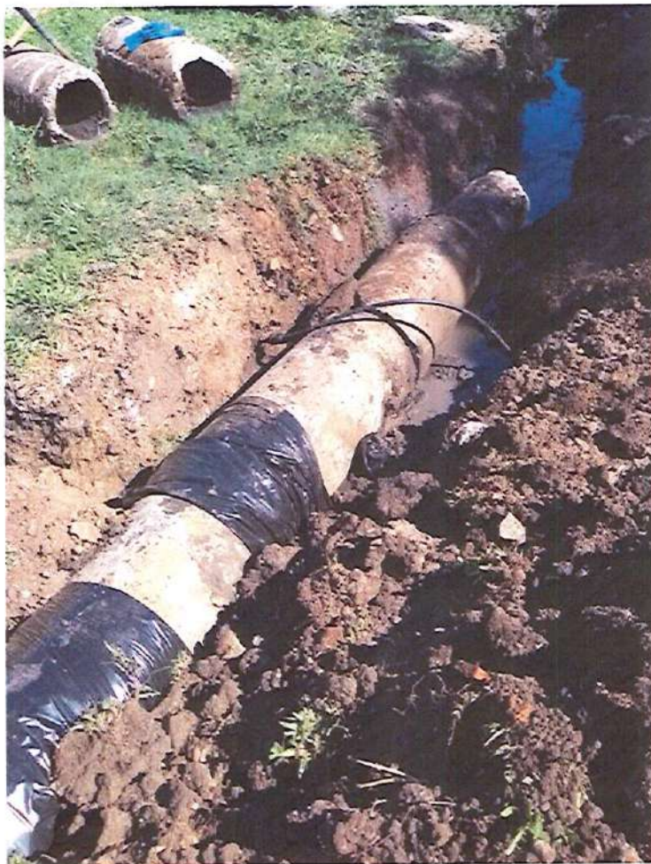
Doc. II - Ruptura de ramal de água para assentamento de tubulação de coleta pluvial
