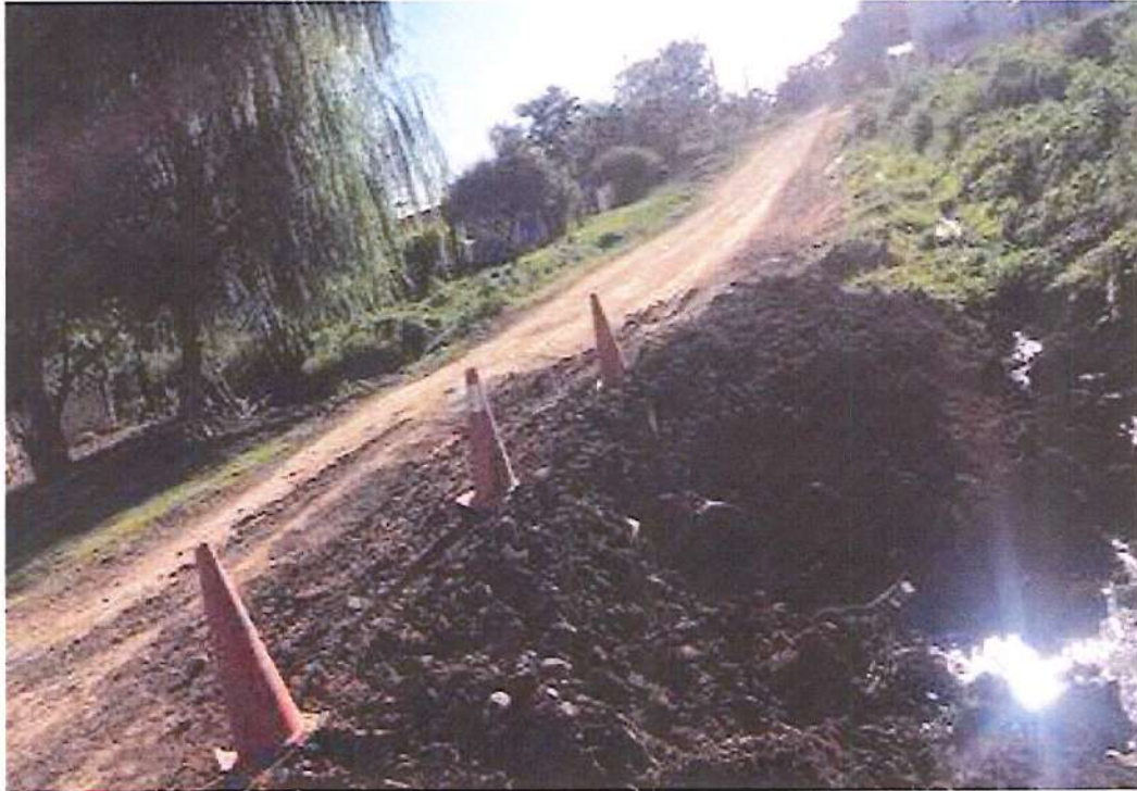
Doc. IV - Ruptura de rede de esgoto para assentamento de tubulação de coleta pluvial
