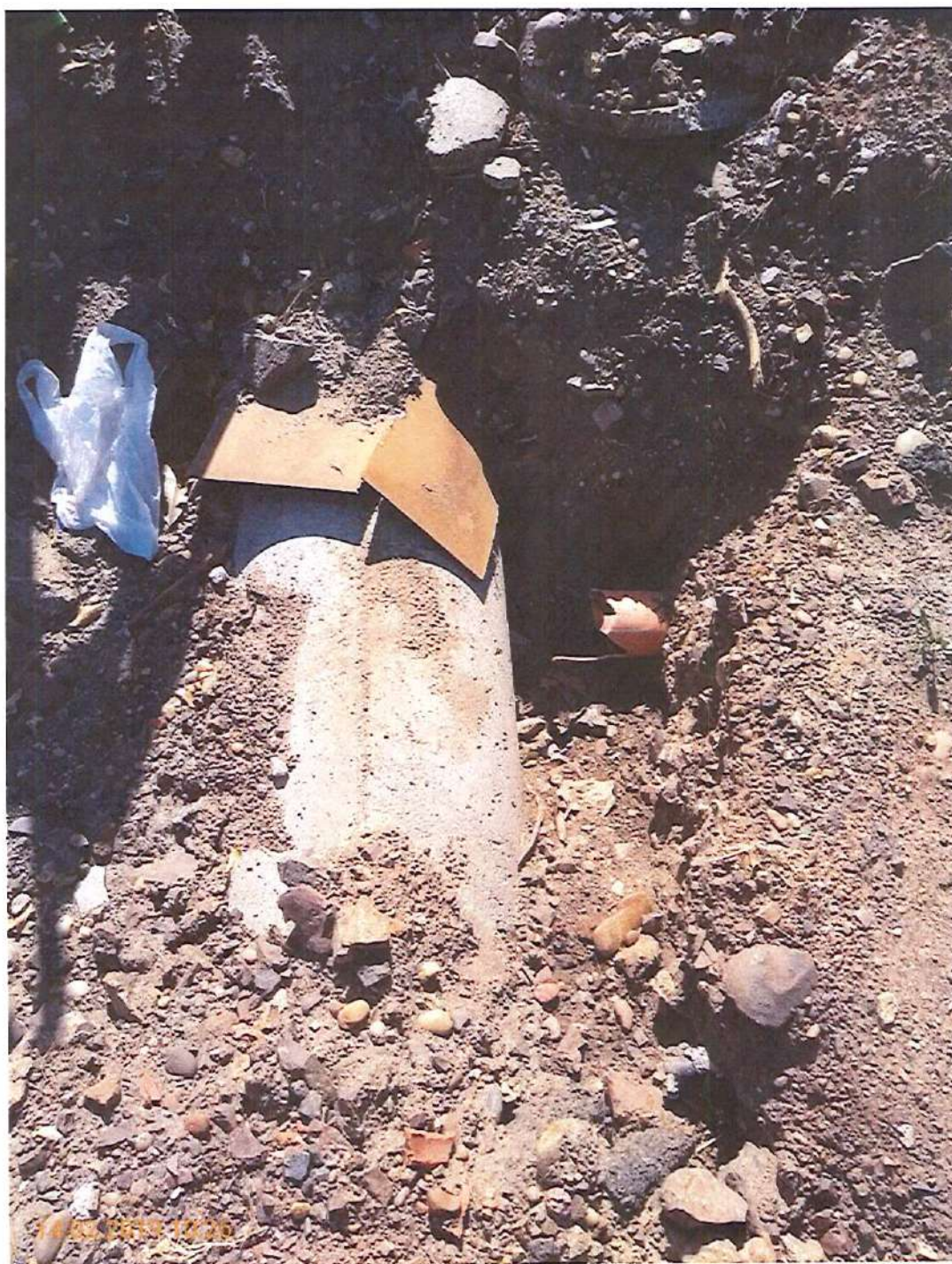
Doc. VII - Ruptura de Ramal de Esgoto para assentamento de rede de coleta pluvial na Travessa José Francisco
