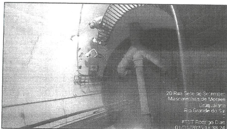
Figura 4 - Poço de Captação inundado
