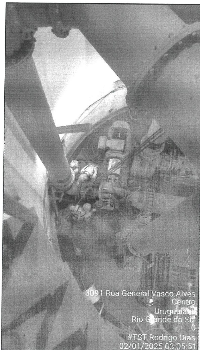
Figura 6 - Manutenção da peça danificada e dos motores
