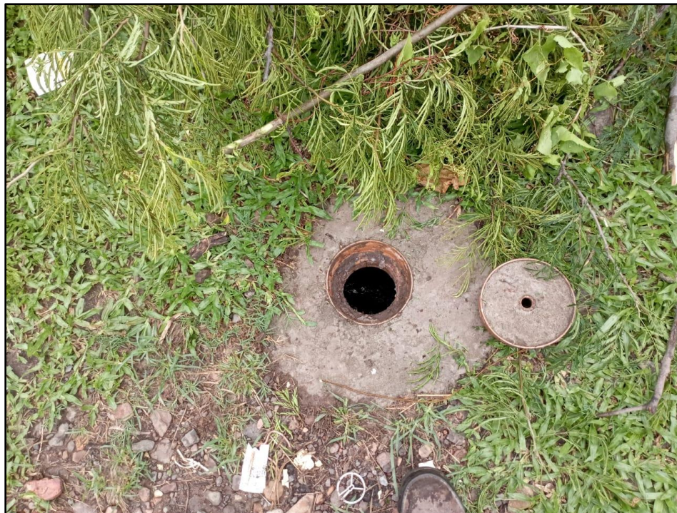
Figura 4- Ramal de esgoto do CDC nº 1729305 fluindo normalmente.
