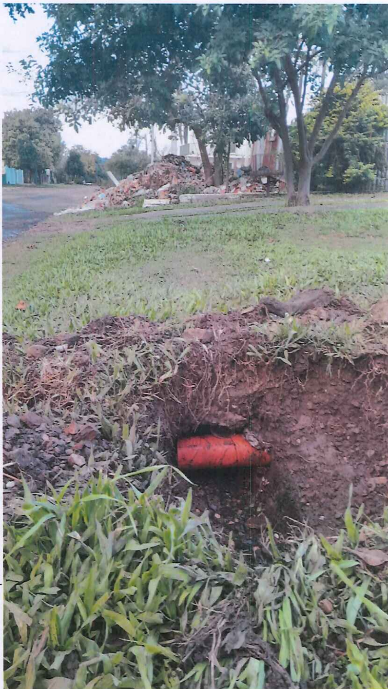
Esgoto em via pública - indício de crime ambiental
