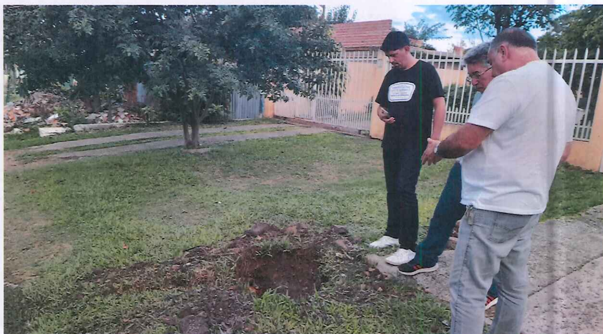
Rua Vasco Alves nº 3616, bairro Santo Antônio, em Uruguaiana Rede de Esgoto (identificação do problema)
