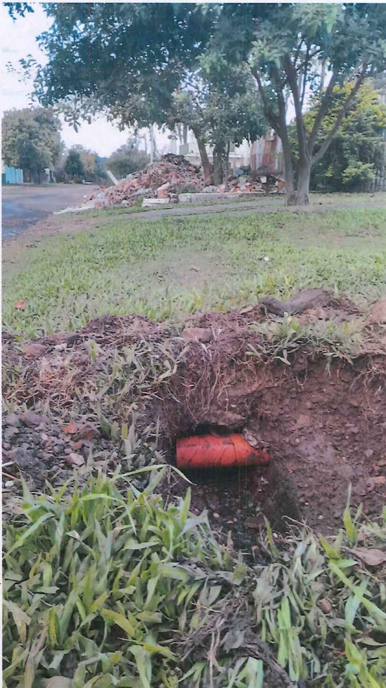
Esgoto em via pública - indício de crime ambiental
