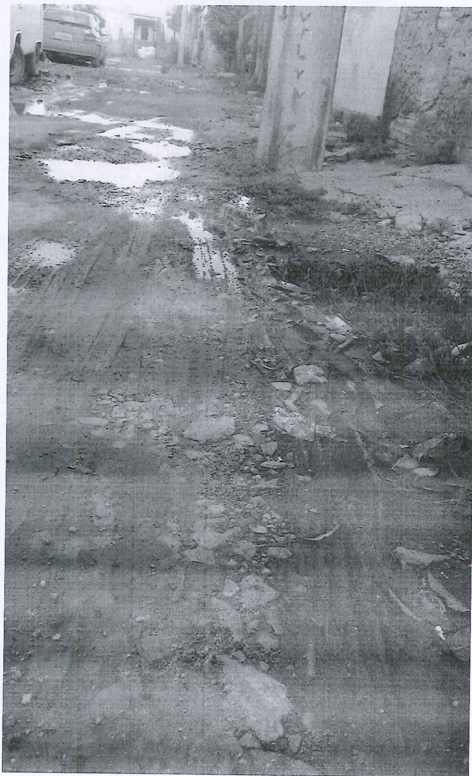
Esgoto invadindo residência e calçadas e danos ao pavimento
